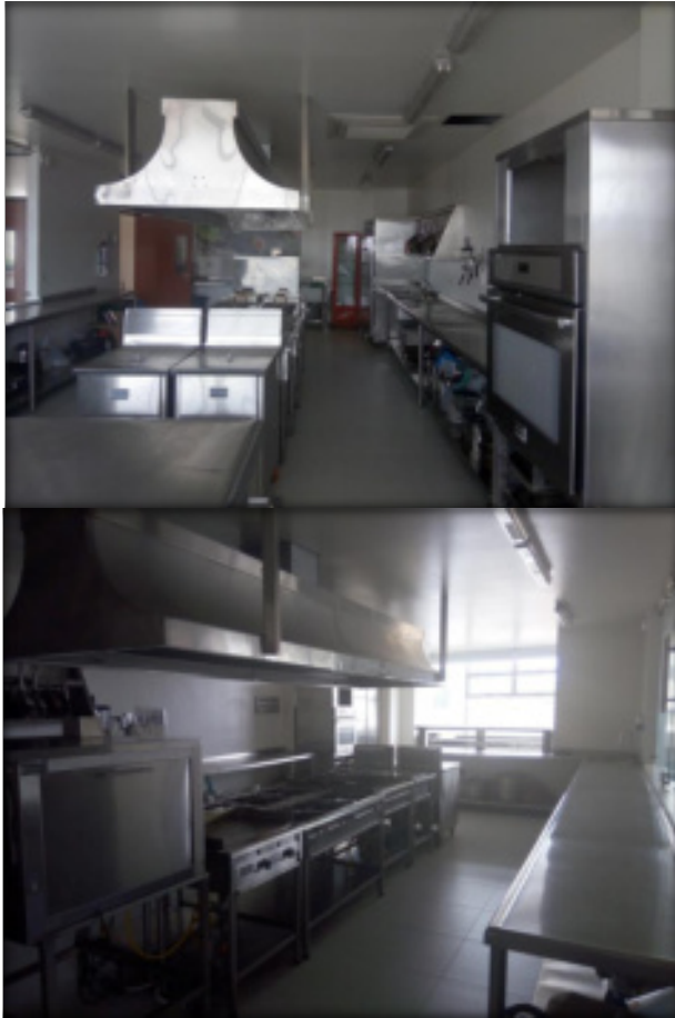
Vista de la cocina industrial
