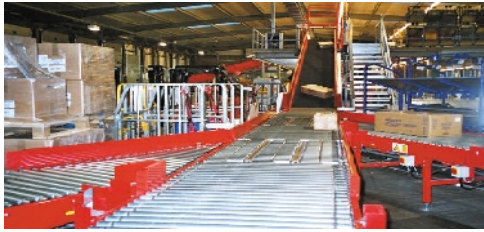
Ilustración 155. Sorting Conveyor / Banda Transportadora Clasificadora
